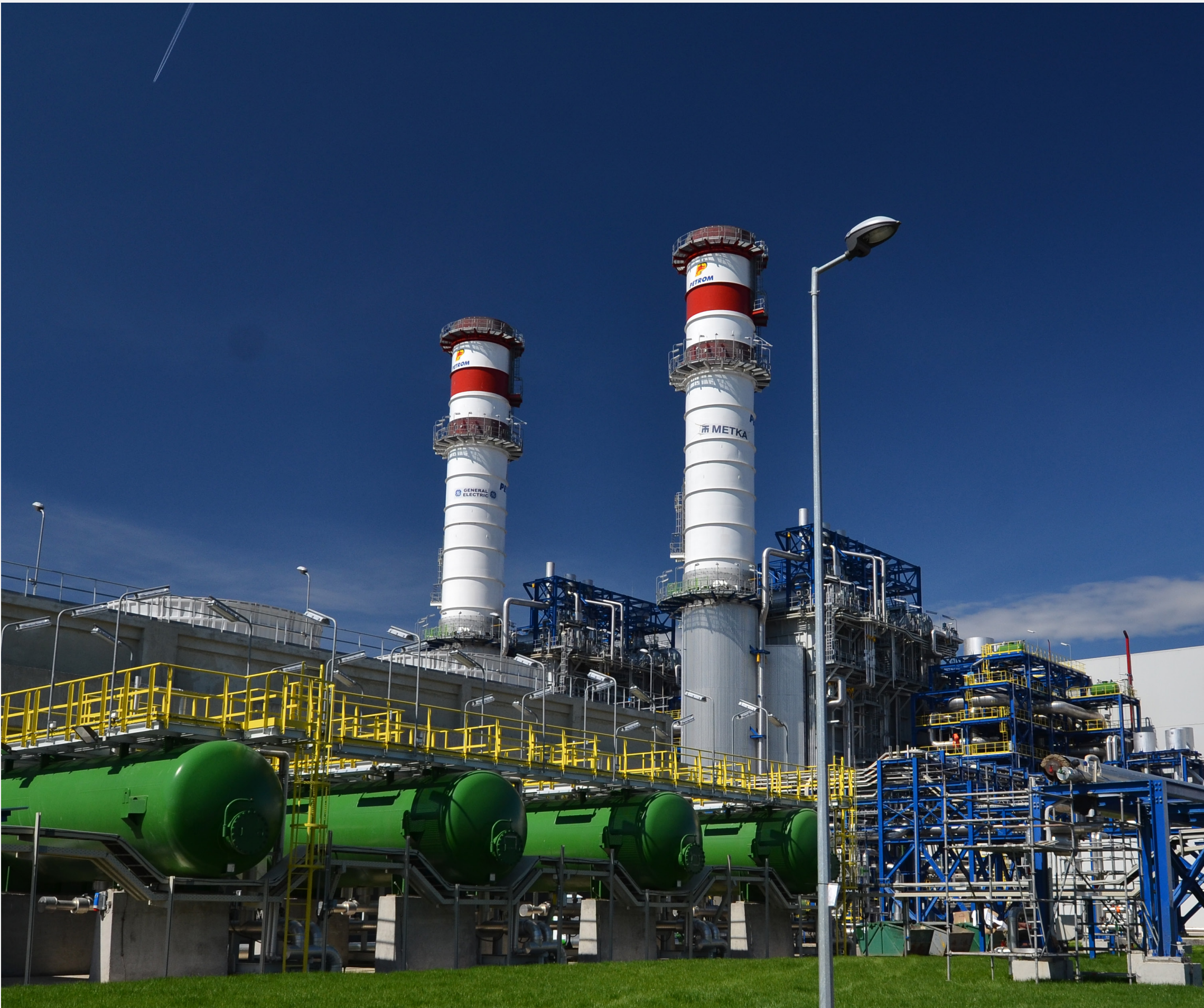
Centrala electrică cu ciclu combinat Brazi
